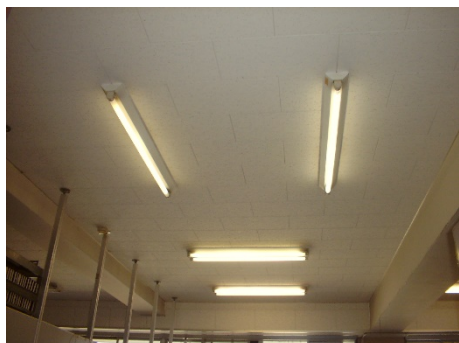
改修前（蛍光灯）
